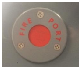
Feuerlöschöffnung auf der Backbordseite der Konsole
