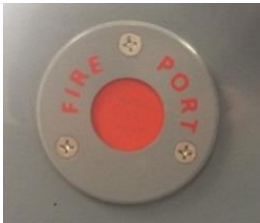
Feuerlöschöffnung auf der Backbordseite der Konsole
